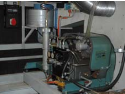
Compresseur air 220 bars pour plongée
